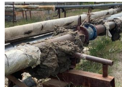
До ремонта сетей ГВС от ЦТП "Геологов"
